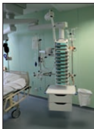
Colonne en soins intensifs suspendue au plafond: le sol est libre de toute roulette, fils, ...
